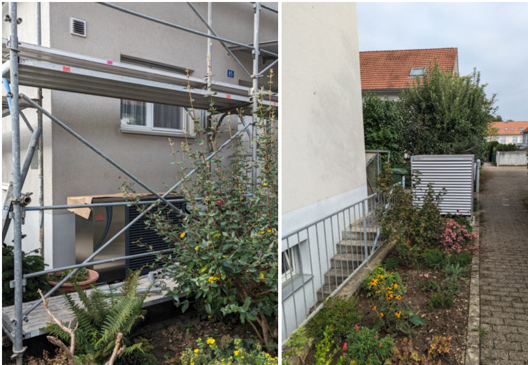
Abbildung 2: Installierte Luft-Wasser-Wärmepumpen in Aussenaufstellung an der Oerinstrasse 85 (links) und 55 (rechts)
